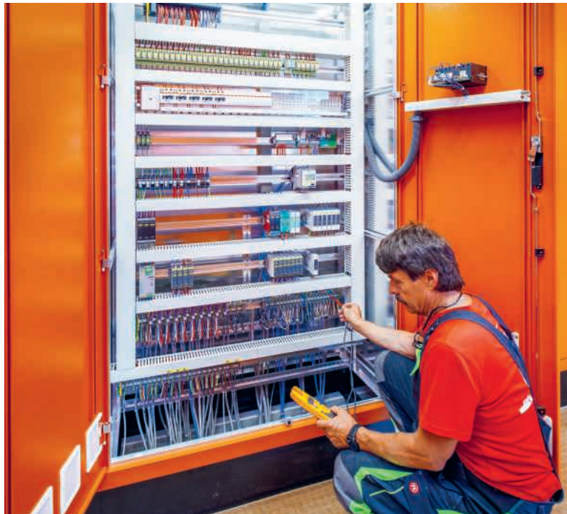
ARA Tiefencastel (GR)
